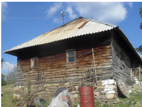
Das alte abruchsreife Haus
